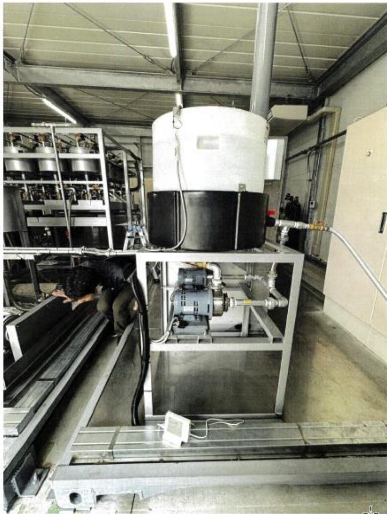
水オイル混合タンク
